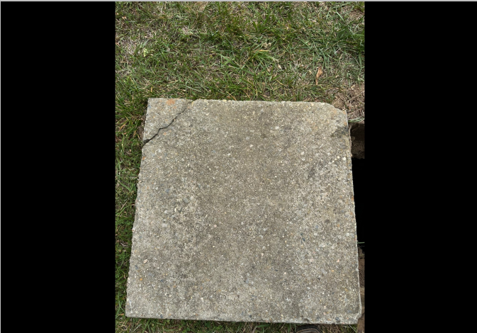
Broken riser lid
