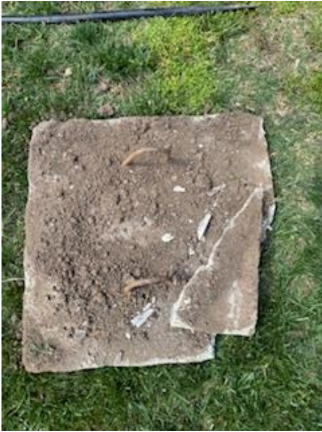
BROKEN RISER LID
